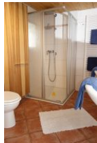
...und großer Duschkabine.
